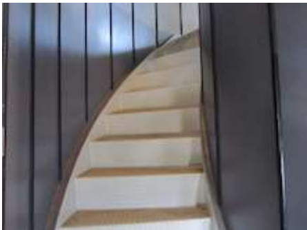
シンボルタワー展望台 5(点検のための階段)
